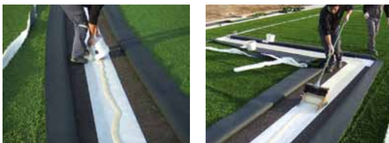
Figura 1. Pegado de una junta de unión de una pista de pádel de césped artificial
